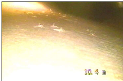
写真-4 管路内流水際の死骸
